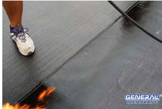
Fig. 10 – cordolo fuoriuscito dalla linea di sormonto
